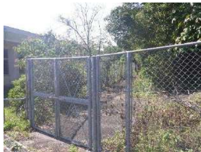
⑥北側狭小道路より老朽化 ネットフェンスと隣接雑木林
