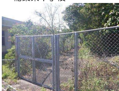
⑥北側狭小道路より老朽化 ネットフェンスと隣接雑木林
