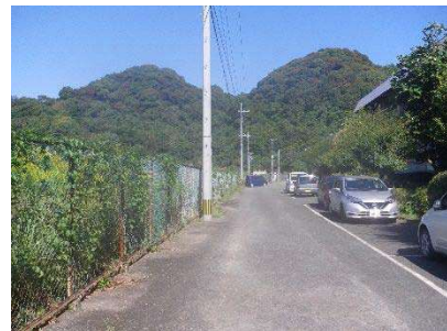
⑧北側敷地内通路 老朽化ネットフェンス
