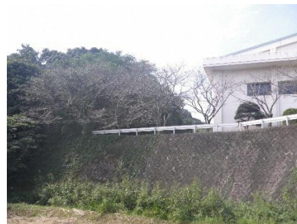
④ 南側体育館に隣接する崖の 危険性がある
