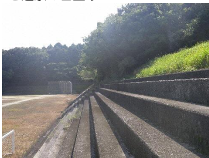
⑤ グラウンド階段型擁壁 崖崩れの危険性がある
