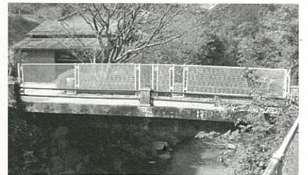
老朽化した大力橋
