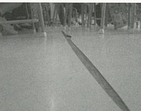
床のひび割れ(稲築西小)
