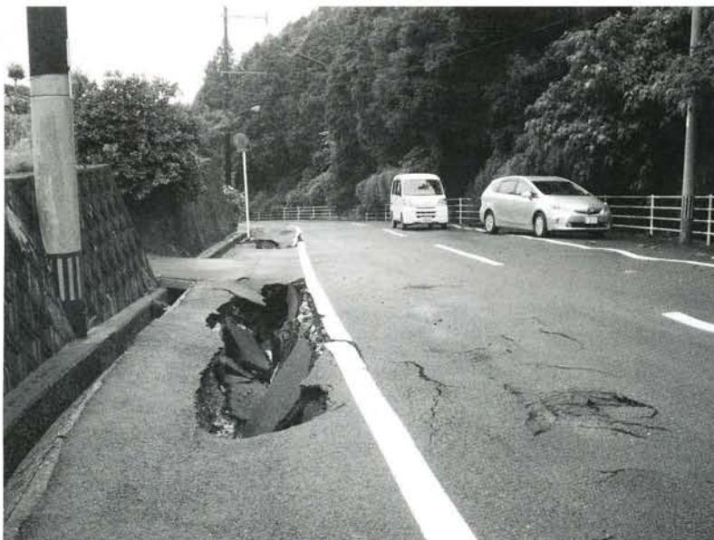
道路が陥没した山田吉庵地区
