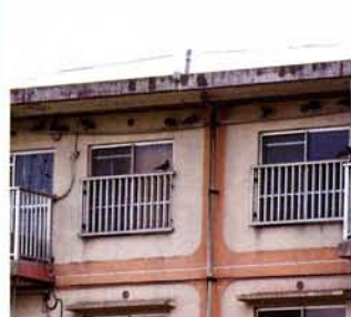
ハトが住みつく市営住宅
