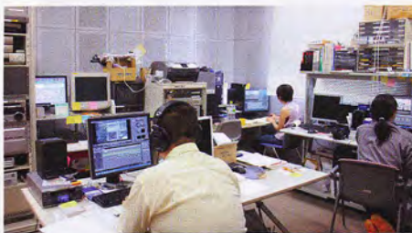
ケーブルネットワーク設備
