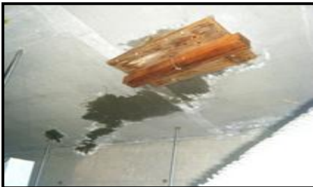
【碓井庁舎】天井雨漏り
