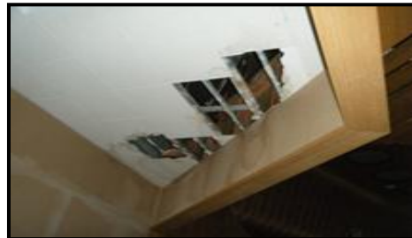
【山田庁舎】雨漏りのため天井破損
