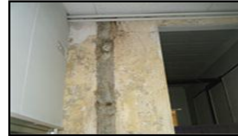
【稲築庁舎】壁、天井剥離・亀裂箇所
