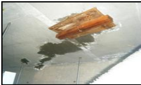
【碓井庁舎】天井雨漏り
