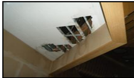
【山田庁舎】雨漏りのため天井破損
