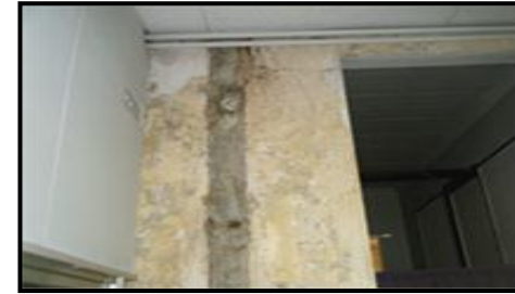
【稲築庁舎】壁、天井剥離・亀裂箇所
