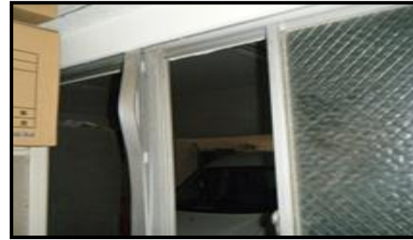
【嘉穂庁舎】建物加重による地下サッシ変形、開閉不可
