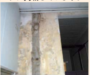
稲築庁舎：1階水道局付近壁劣化
