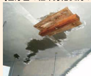
碓井庁舎：放送室天井雨漏り
