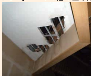
山田庁舎：3階天井雨漏り
