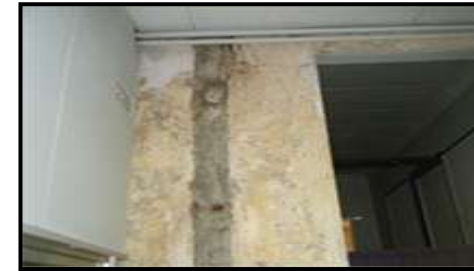
【稲築庁舎】壁、天井剥離・亀裂箇所
