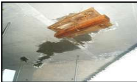
【碓井庁舎】天井雨漏り
