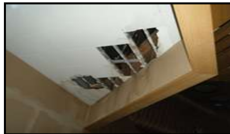
【山田庁舎】雨漏りのため天井破損
