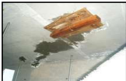
【碓井庁舎】天井雨漏り
