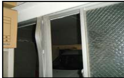
【嘉穂庁舎】建物加重による 地下サッシ変形、開閉不可
