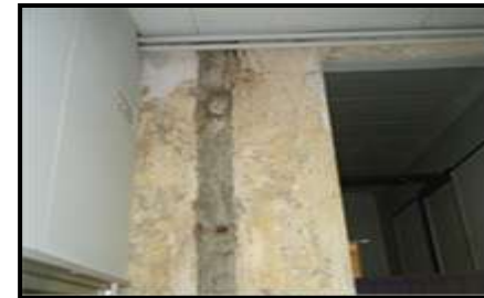
【稲築庁舎】壁、天井剥離・亀裂箇所
