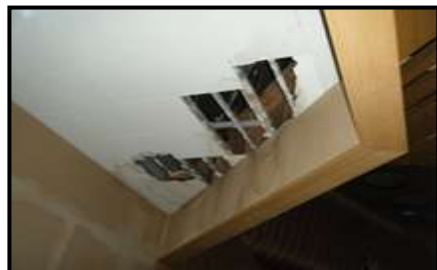
【山田庁舎】雨漏りのため天井破損
