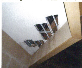
山田庁舎：3階天井雨漏り
