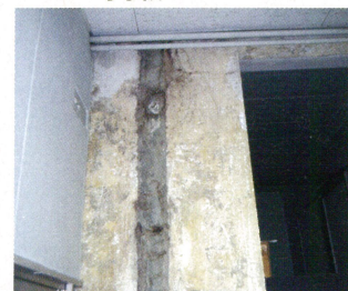
稲築庁舎：1階水道局付近壁劣化
