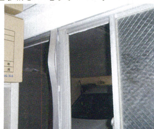
嘉穂庁舎：建物加重にて地下サッシ変形により開閉不可
