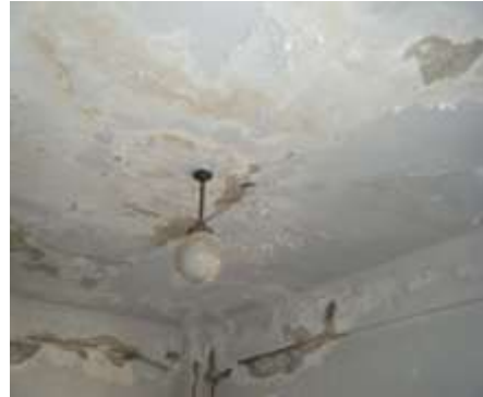
雨漏りによる天井剥離・亀裂箇所 （稲築庁舎3階 屋上入口階段）
