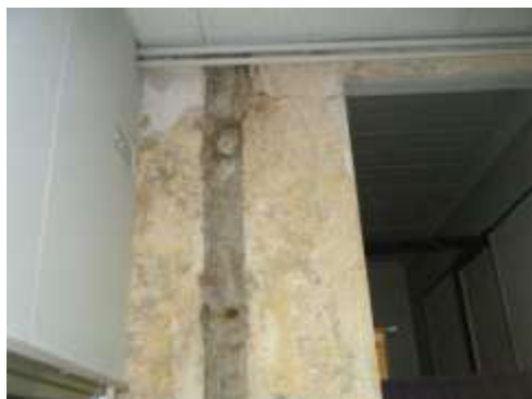
雨漏り等による壁、天井剥離・亀裂箇所 （稲築庁舎1階 水道局・総合窓口課）
