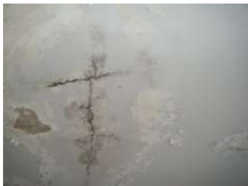
雨漏り等による壁剥離・亀裂箇所 （稲築庁舎3階 屋上入口階段）
