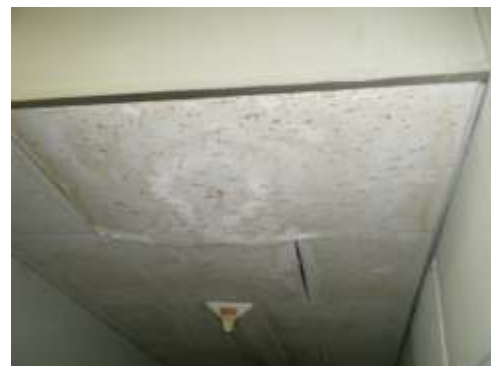
雨漏りによる天井腐食箇所 （稲築庁舎1階 水道局）
