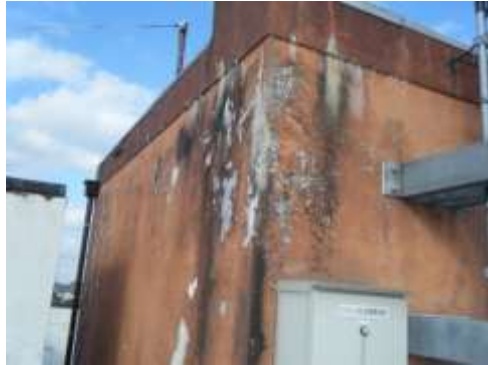
雨漏りによる壁剥離・亀裂箇所 （稲築庁舎 屋上）
