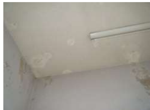
雨漏りによる天井腐食箇所 (嘉穂庁舎北側1階 非常階段)
