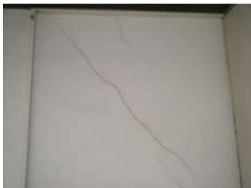
壁亀裂箇所② (嘉穂庁舎北側1階 非常階段)
