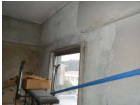
雨漏りによる壁剥離箇所 (嘉穂庁舎南側3階 屋上出入口付近)
