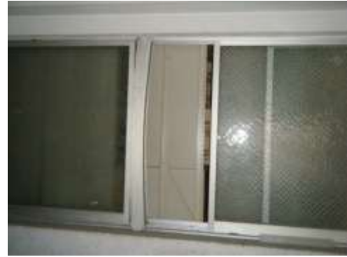
窓枠歪み、開閉不可箇所② (嘉穂庁舎地下 書庫)
