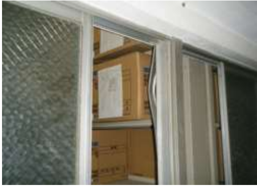
窓枠歪み、開閉不可箇所① (嘉穂庁舎地下 書庫)
