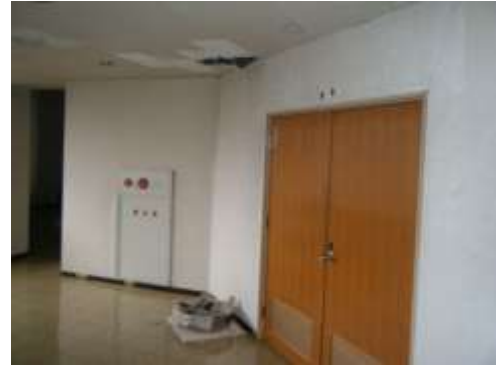
雨漏りのため天井破損箇所② (山田庁舎3階 旧議場入口)
