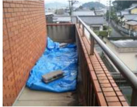
雨漏り防止用ブルーシート設置箇所 (碓井庁舎3階 ベランダ)
