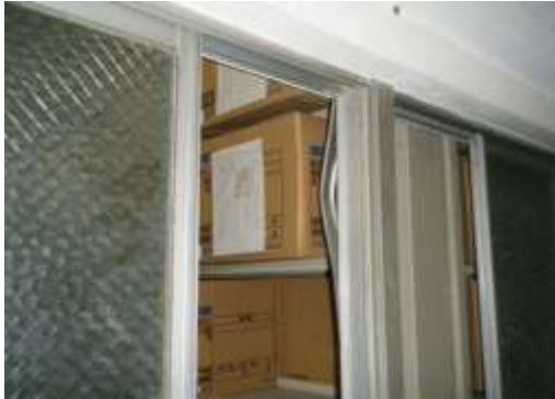
建物加重による地下サッシ変形、 開閉不可箇所①（嘉穂庁舎地下 書庫）
