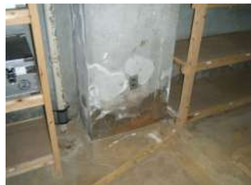
雨漏りによる壁、床腐食剥離箇所 (山田庁舎地下 機械室)
