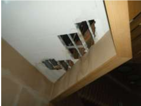
雨漏りのため天井破損箇所① (山田庁舎3階 旧議場内)
