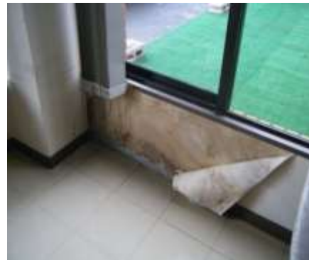
雨漏りによる壁紙剥離箇所 (碓井庁舎3階)
