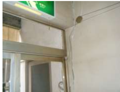
壁亀裂箇所① （嘉穂庁舎南側2階 階段前）
