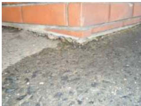
雨除け支柱基礎剥離箇所 (碓井庁舎1階 玄関入口右側)
