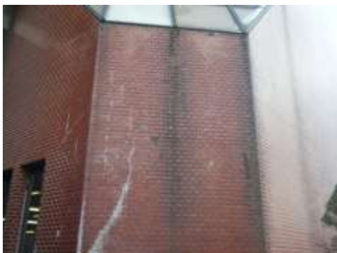
壁亀裂、剥離箇所 (山田庁舎1階 玄関入口右側)
