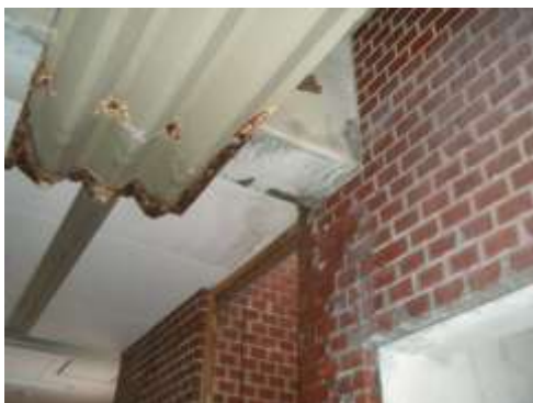
雨漏りによる天井、外壁劣化剥離箇所 (山田庁舎3階 非常階段右側)
