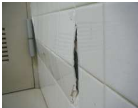
壁設置タイル剥離、破損箇所 (碓井庁舎1階 女子トイレ)
