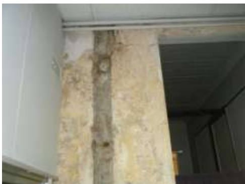
雨漏り等による壁、天井剥離・亀裂箇所 (稲築庁舎1階 水道局・総合窓口課)
