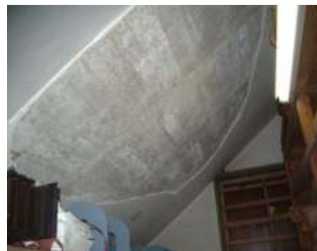
雨漏り等による壁剥離・亀裂箇所 (稲築庁舎1階 階段下倉庫)
