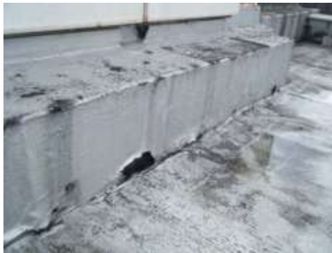
雨漏り防止用防水シート、外壁劣化剥離箇所 (碓井庁舎 屋上)
