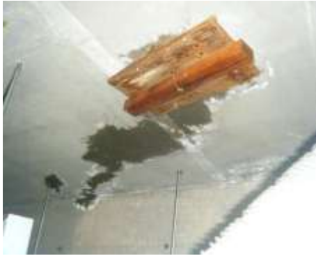
天井雨漏り箇所 (碓井庁舎2階 放送室天井裏)
