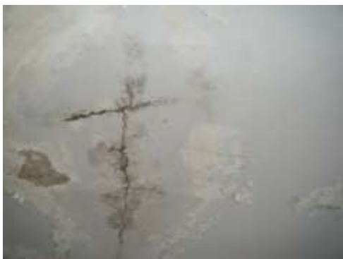
雨漏り等による壁剥離・亀裂箇所 (稲築庁舎3階 屋上入口階段)
