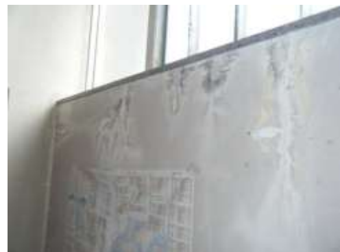
雨漏りによる壁剥離、亀裂箇所 (山田庁舎中2階 階段)
