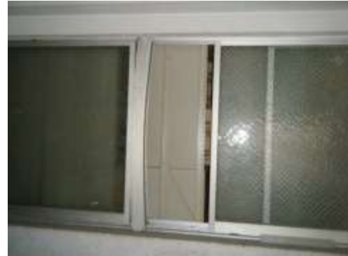
建物加重による地下サッシ変形、 開閉不可箇所②（嘉穂庁舎地下 書庫）
