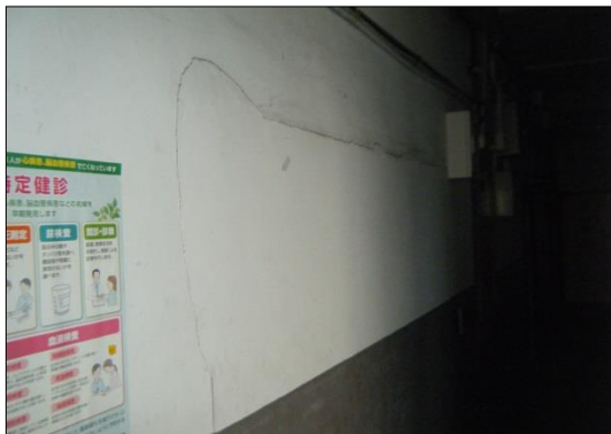
写真 1 1 F 右側通路壁亀裂
