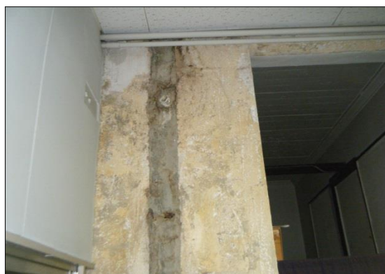
写真 3 1 F 水道局壁雨漏り剥離
