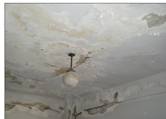
写真 6 3 F 階段屋上入口天井雨漏り剥離
