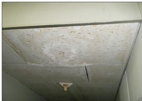
写真 2 1 F 水道局天井雨漏り
