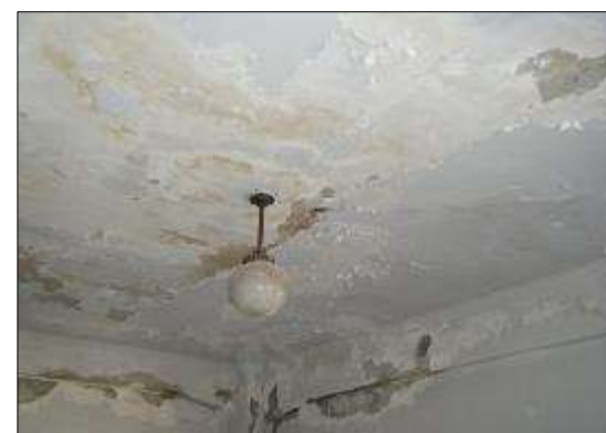
写真6 3F 階段屋上入口天井雨漏り剥離
