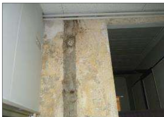
写真3 1F 水道局壁雨漏り剥離
