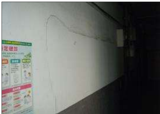
写真1 1F 右側通路壁亀裂
