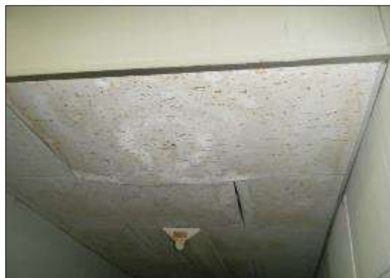
写真2 1F 水道局天井雨漏り
