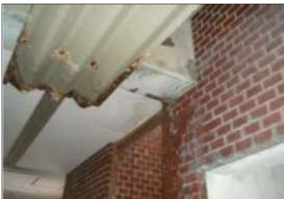
写真2 雨漏りによる天井、外壁劣化剥離箇所
