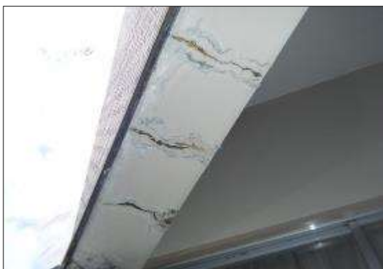
写真4 2F書庫奥部屋雨漏り壁亀裂・剥離
