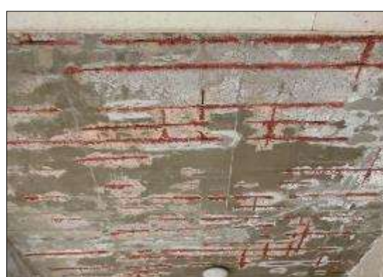
写真7 1F高齢者介護課横天井剥離
