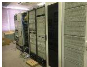
写真 34 ヘッドエンド設備
