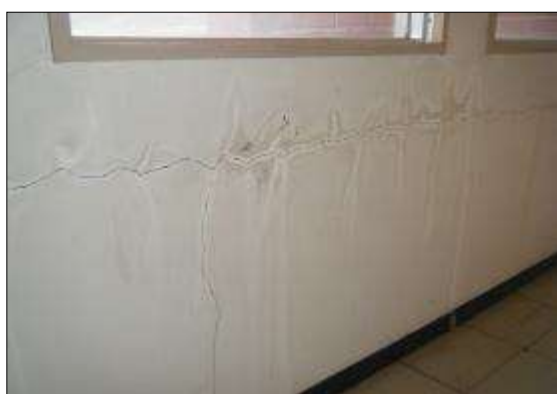
写真6 3F旧議場傍聴席通路壁亀裂
