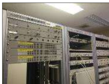
写真 35 ヘッドエンド設備
