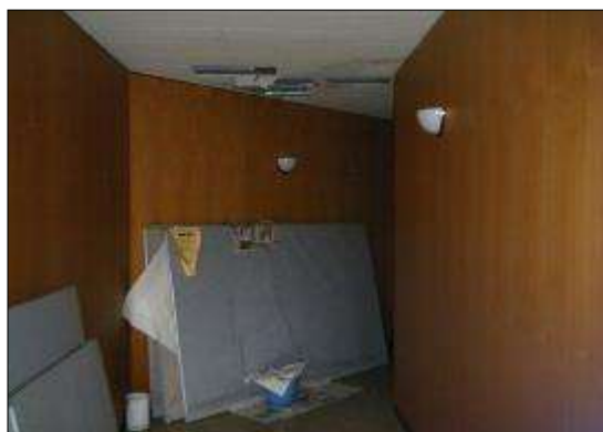
写真5 3F旧議場通路雨漏り
