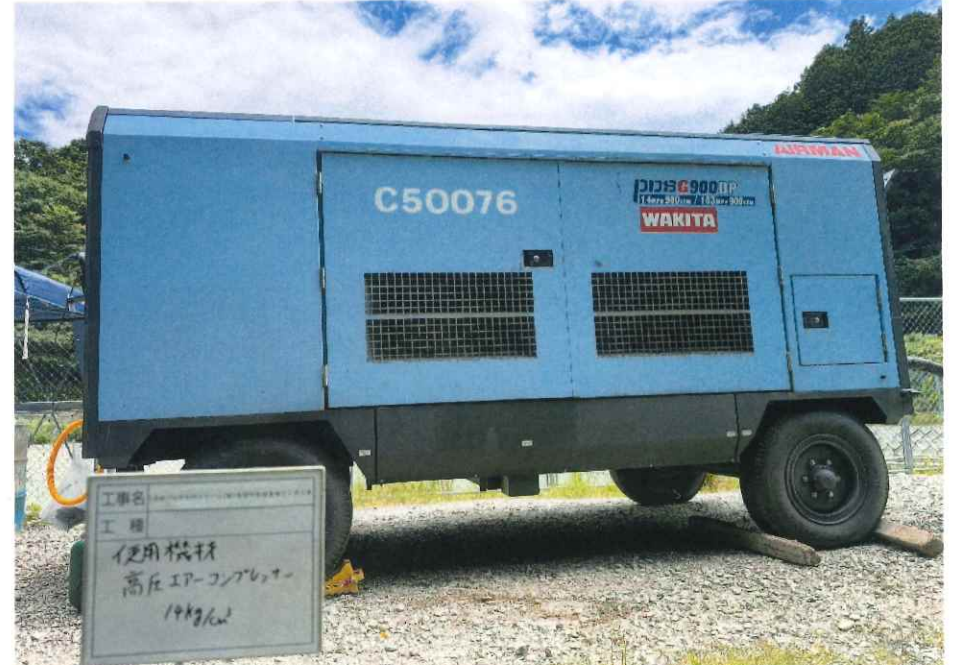
使用するエアコンプレッサー
