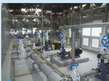
浄水場設備設置例
