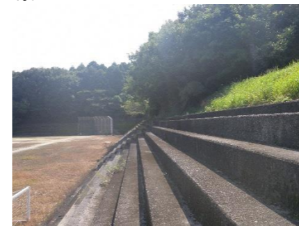
⑤ グラウンド階段型擁壁を囲う形の平山崖の危険性がある
