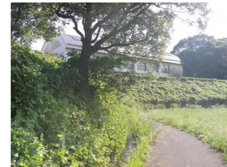
⑧ 西側法面にある高木と水路 雑草の対策が必要
