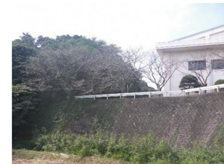
④ 南側体育館に隣接する平山崖の危険性がある
