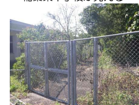
⑥ 北側狭小道路より老朽化ネットフェンスと隣接雑木林が見える
