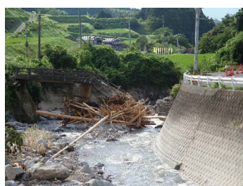
平成28年発生の桑野地区橋被害
