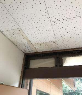
都市と農村交流室、伝承工作室入口雨漏り跡
