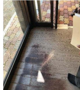
都市と農村交流室、伝承工作室入口。樋より排出できない雨水の漏水跡
