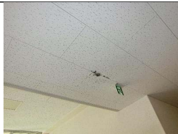
2階・廊下天井（漏水跡・カビ）
