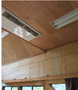
都市と農村交流室（天井・雨漏り跡）
