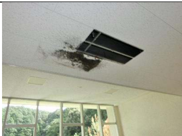
2階・廊下天井（漏水跡・カビ）
