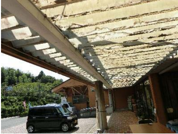
雨樋が小さく、雨水を吐ききれない。
