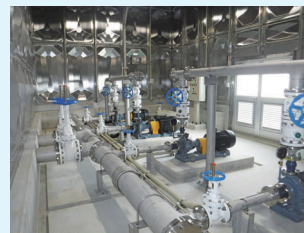
浄水場機械室配管
