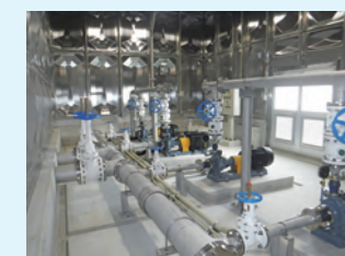
浄水場機械室配管
