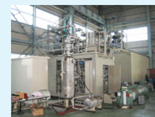
サーマルリサイクル発電装置
