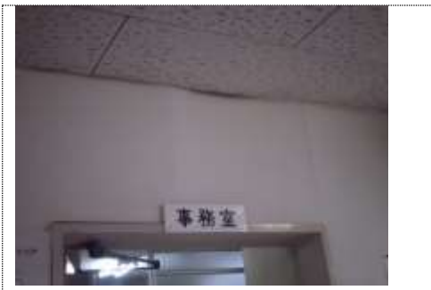
(事務室入口前天井(たわみ))
