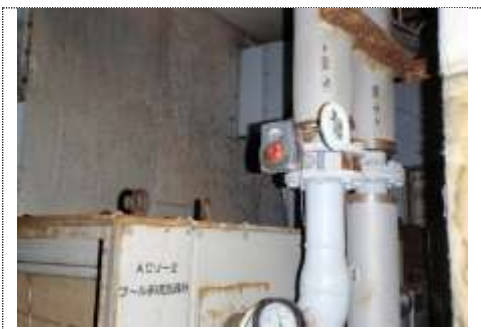
（ プール水温調整機 ）
