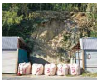
▲上山田蛭子地区被災現場
