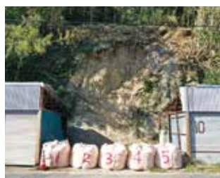
▲上山田蛭子地区被災現場
