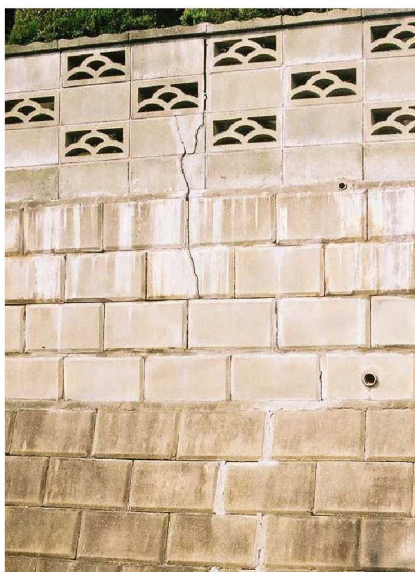
擁壁が損傷を受けると、直上のブロック塀も損傷し危険な状態となる
