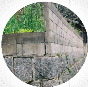
擁壁上のブロック塀 の危険性
