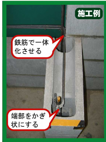
控壁には径9mm以上の鉄筋を配置し、ブロック塀と一体となるよう施工する
