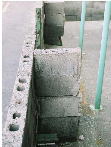
塀と一体に施工されていないため、地震で損傷を受け、役目を果たせなかった控壁
