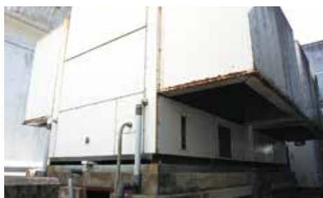
▲サルビアパークの交換予定のチラー(冷却水循環装置)
